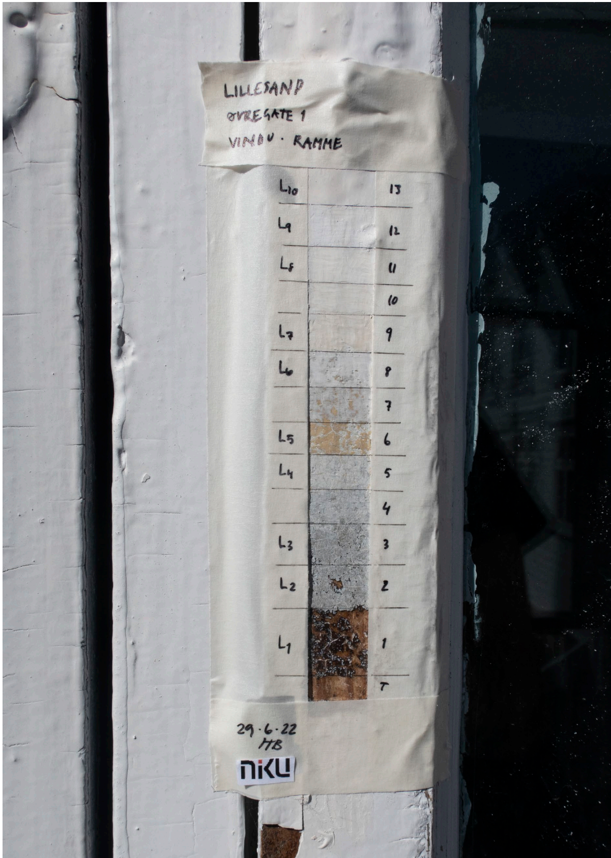
Figur 18 Lagvis avdekking på vindusrammen. Avdekningen er laget på første vindu fra nord i 2. etasje. Ikke alle lag avdekket. Foto: NIKU, 2022.
